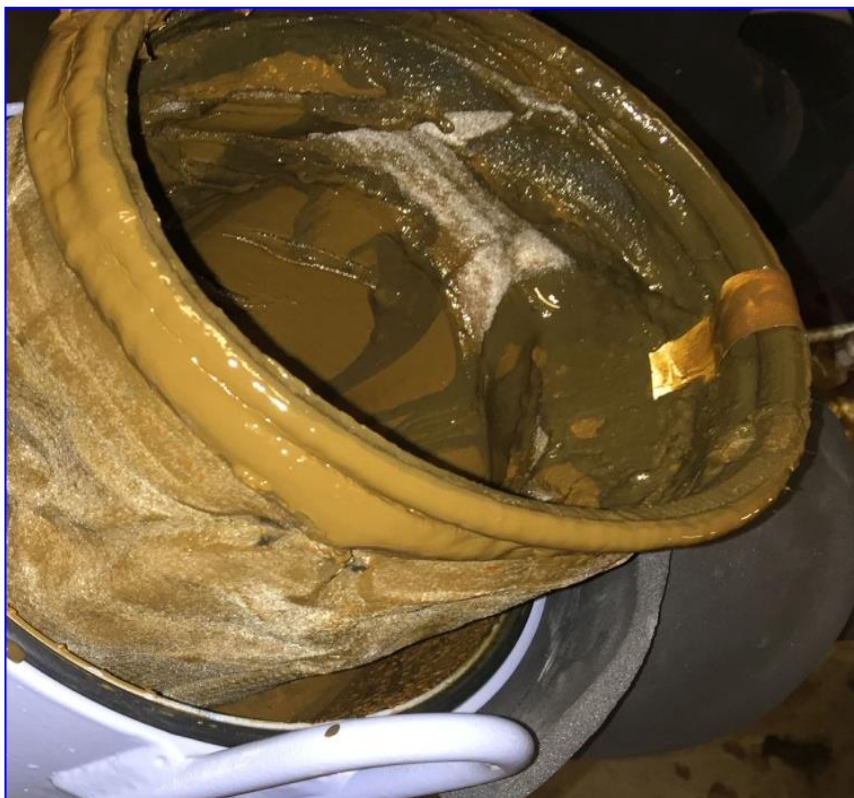
Detta är en filterinsats från det beskrivna objekt 101 (sid 25) före åtgärd
