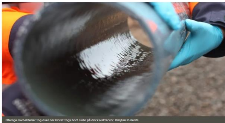
Ofarliga rovbakterier tog över när klorlet togs bort. Foto på dricksvattenrör: Kristjan Pullerits
